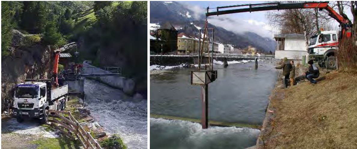
Abbildung 14: Vorbereitung des Geschiebefangnetzes am Pegel Vent/Rofenache (linkes Bild), Absenken des Geschiebefangkorb an der Führungssäule am Pegel Lienz/Isel (rechtes Bild) durch IWA/BOKU (Quelle: HD Tirol)
