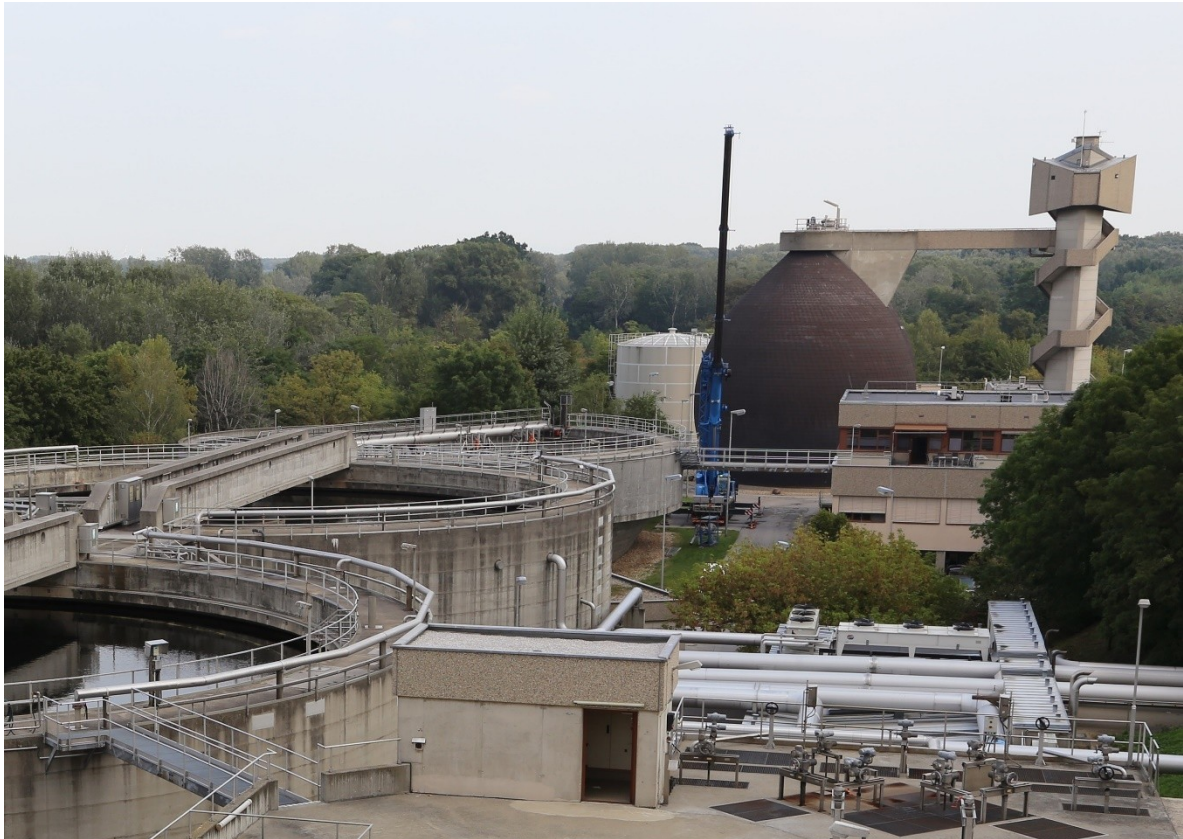
Kläranlage mit Faulturm © Umweltbundesamt/Bernhard Gröger.
