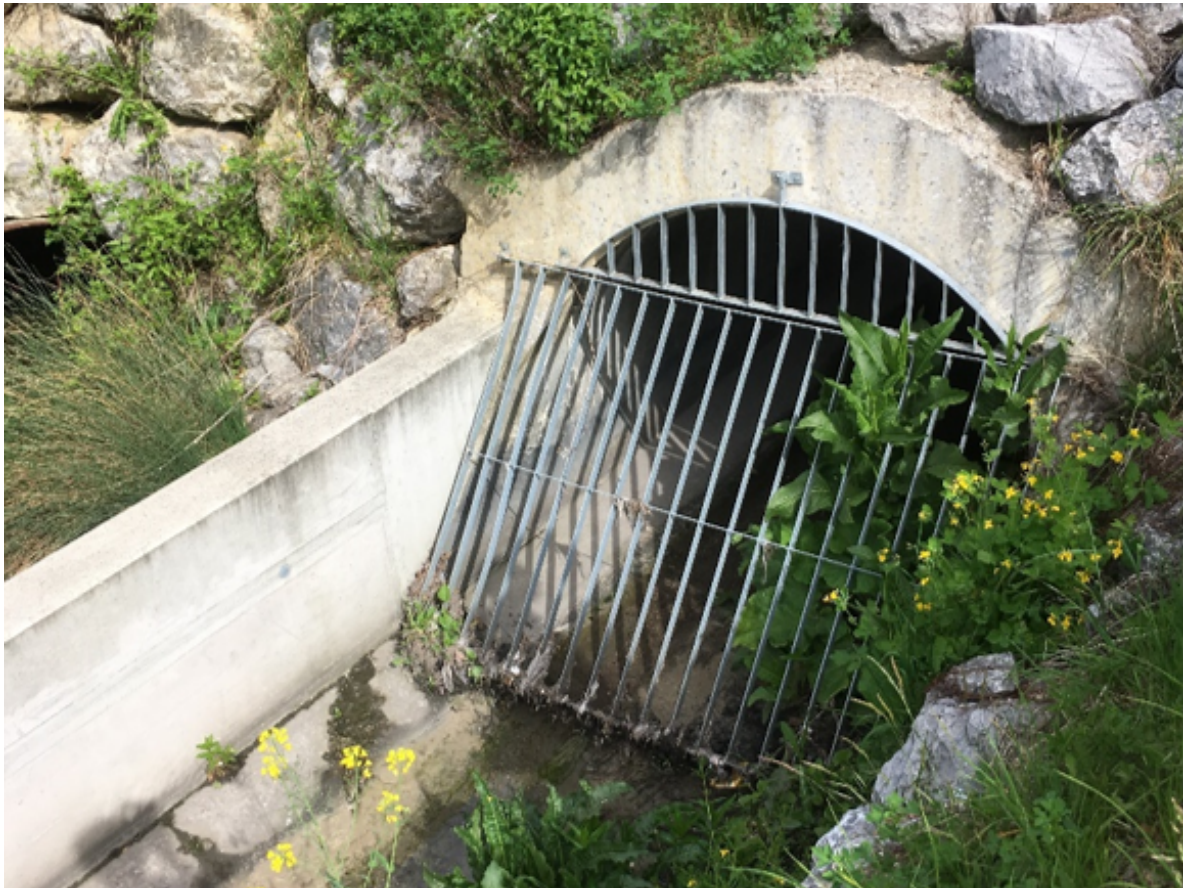
Niederschlagswassereinleitung aus der Trennkanalisation, © BMLUK/Katharina Lenz.
