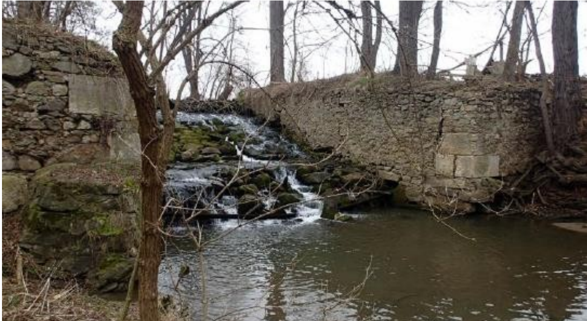
Abbildung 24 Nicht fischpassierbares Querbauwerk an der Pulkau
