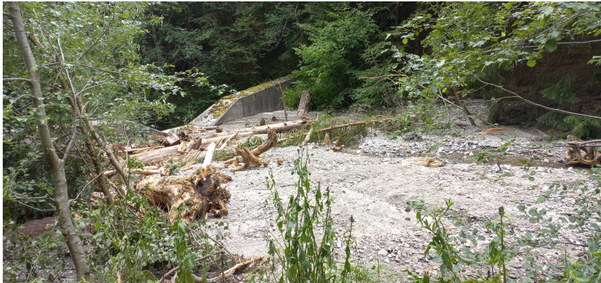
Abbildung 1: Verfüllte Geschiebedosiensperre am Plaikengraben (hm 12,6) beim Ereignis vom 29.06.2022
