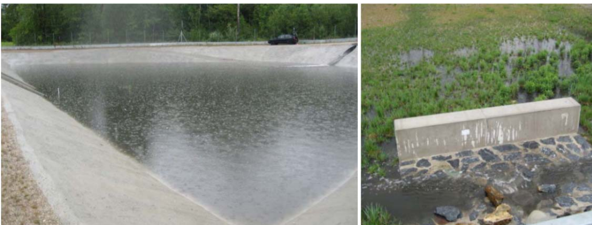
Abbildung 87: Regenereignis vom 22.05.2013 der GSA A2, links: Sedimentationsbecken, rechts: Drosselabfluss ins Filterbecken
