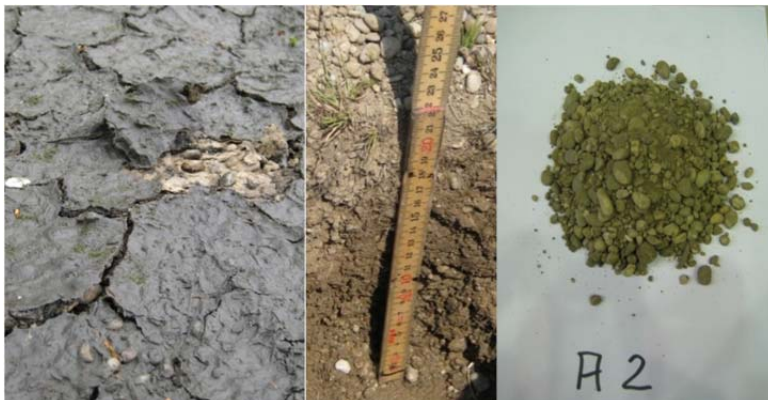
Abbildung 80: 1-Schicht-Bodenfilter Anlage A2, links: abgeplatzte Filteroberfläche der Anlage A2 im Bereich MP2, mittig: Schurf der Anlage A2 im Bereich MP4 und rechts: getrocknetes Filtersubstrat der Anlage A2
